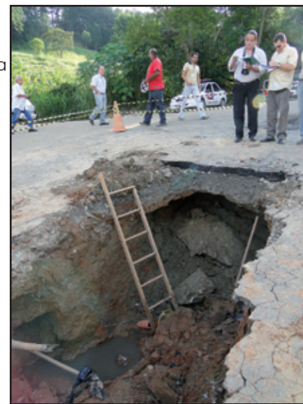
Vala não tinha escoramento
