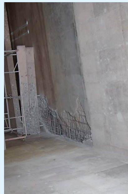
Parede não resistiu
