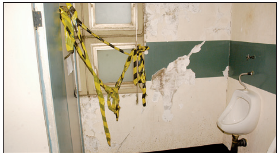
Este banheiro em péssimas condições é apenas um dos exemplos das condições locais
